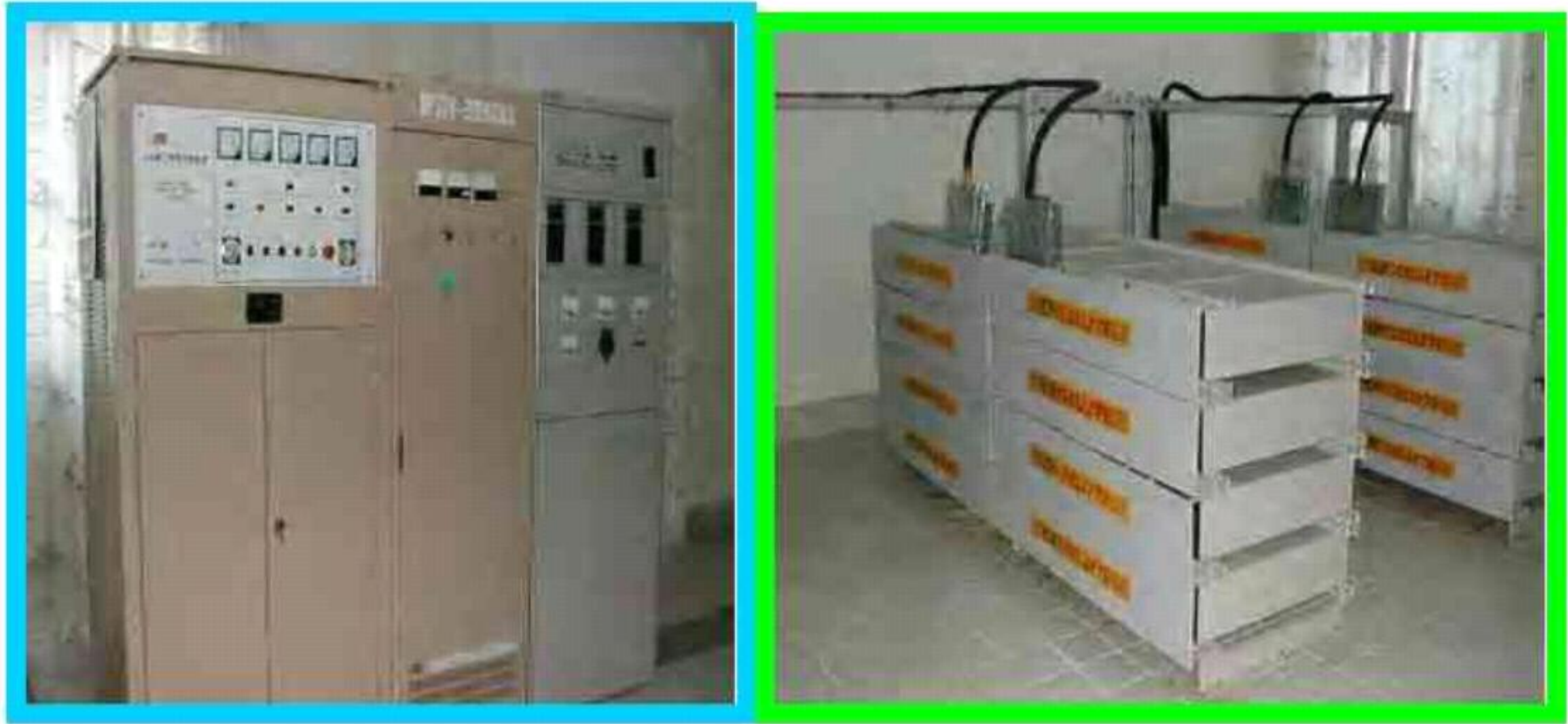
电源机柜与蓄电池
